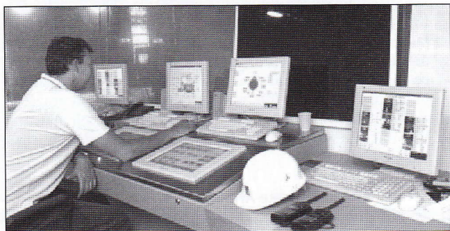
Fig.8 – Cabina di controllo del forno di Dalmine
