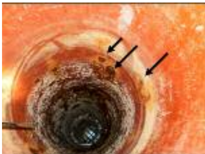
FIG. 8 Aspetto interno del tubo forato con indicazione di alcuni crateri.
