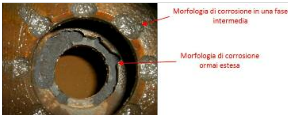
FIG. 3 Aspetto di un coperchio rappresentativo del fenomeno corrosivo. Close up of a cap representing the corrosion phenomenon.
